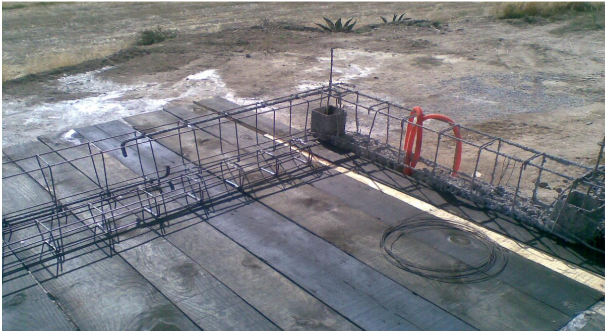
Foto 1.- Se observa el castillo tubular de acero, colado en el interior de Concreto y un alambión al centro para absorber las contracciones por temperatura.
